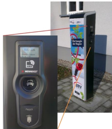
Ladesäule Campus Scheffelberg
